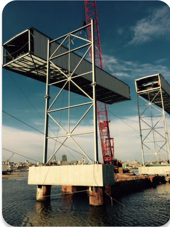
Estructuras tipo biela para soporte de galerías
