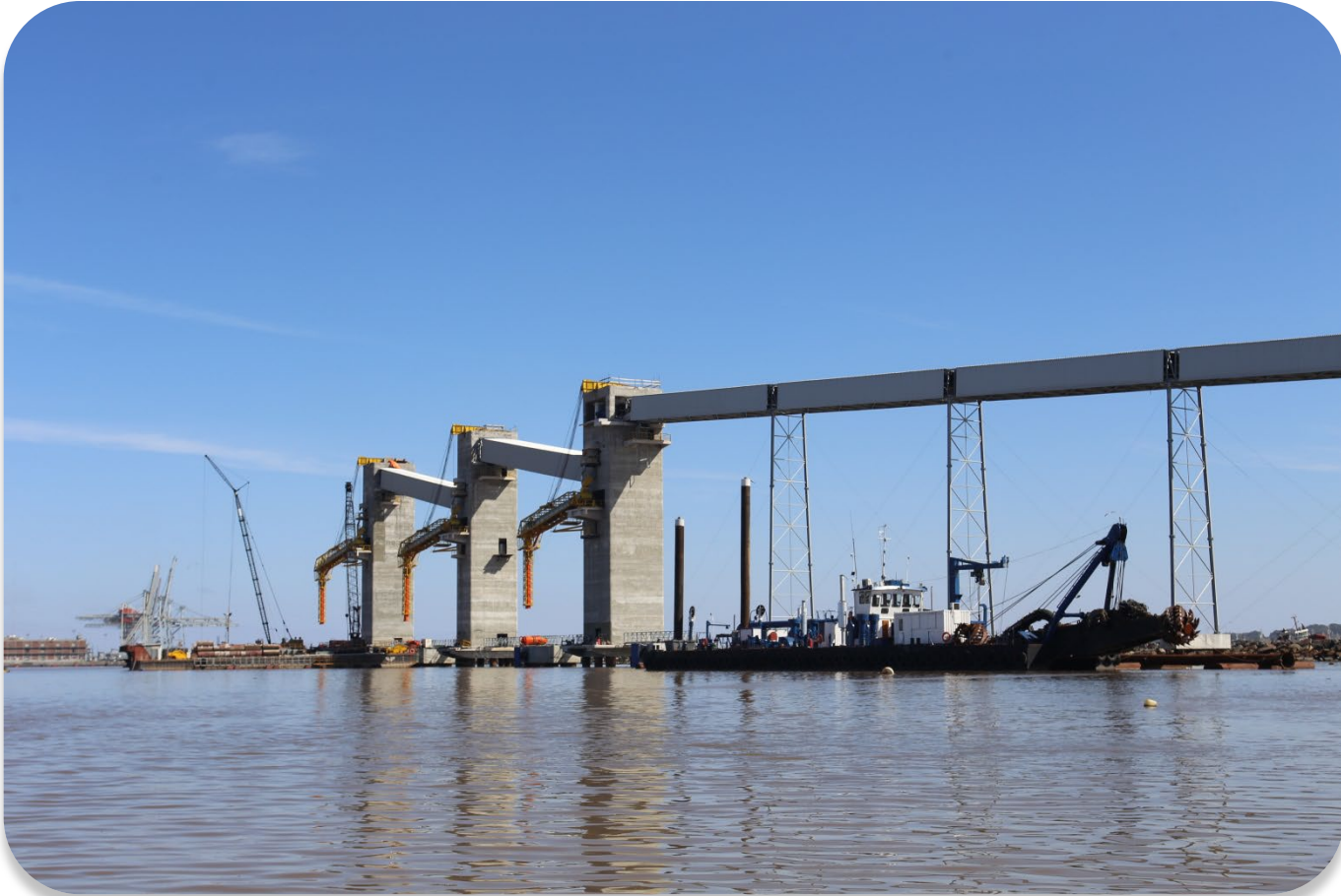
Estructuras tipo biela para soporte de galerías
