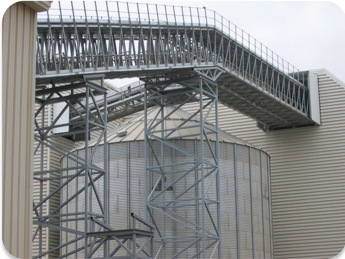
Torres soporte con pasarelas
