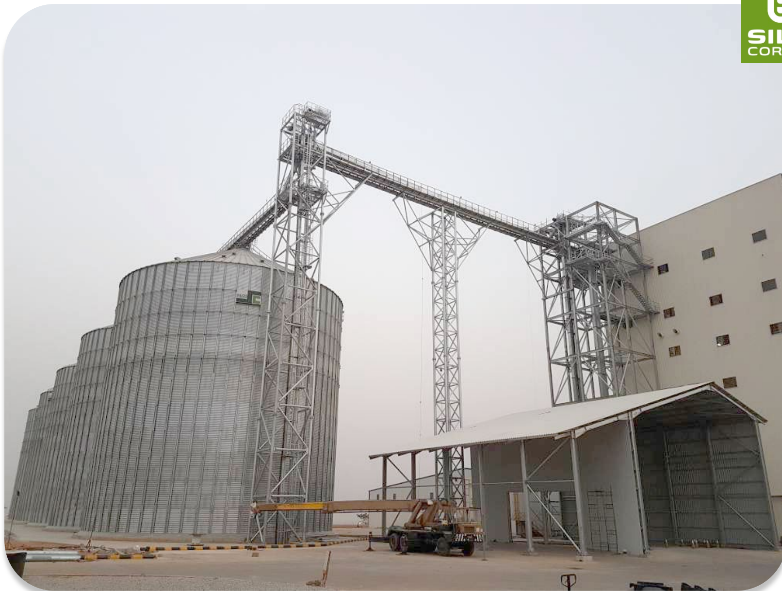
2017 NIGER04 - NIGERIA: 5 silos mod. 24,45/22 – Capacidad total: 50.000 T
